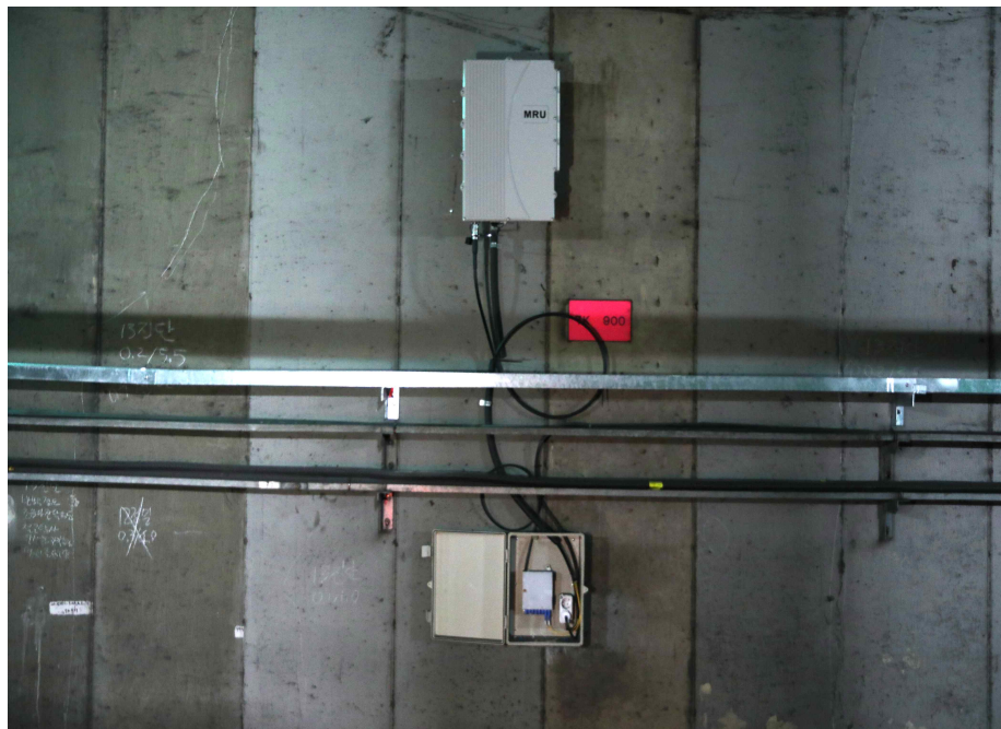
[터널에 설치된 기지국 장치]
